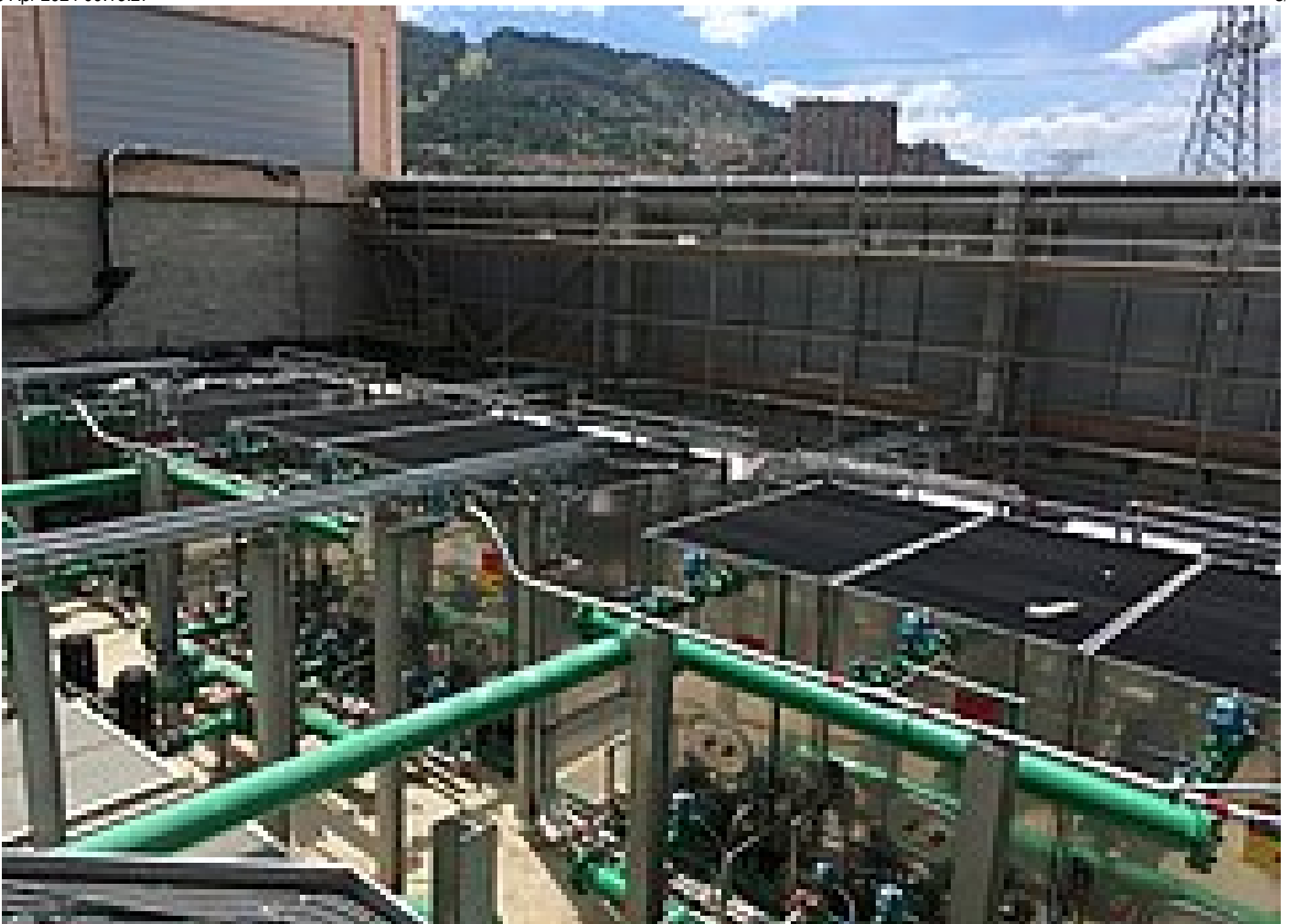
Tours de refroidissement et traitement de l'air évacué
