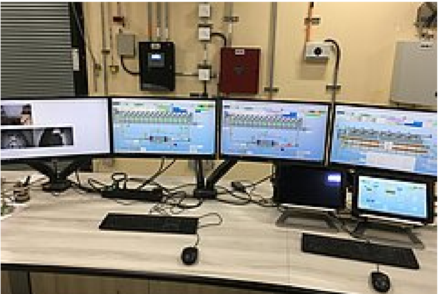
Système de contrôle de l'installation de séchage
