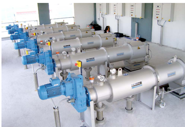
Dégrillage des boues dans une grande station d'épuration.
