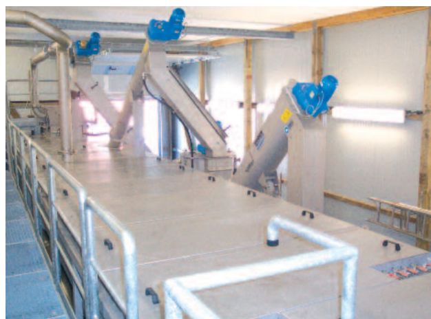
Extraction propre des dégrillés et du sable
