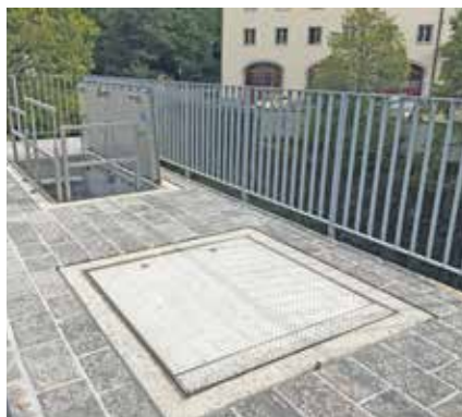
Regard de visite HUBER SD7 porteur.
