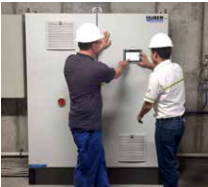
Transfert du savoir-faire au personnel d'exploitation pour un fonctionnement optimal de l'ensemble de l'installation.
