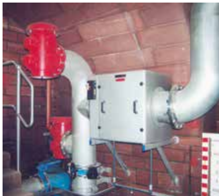
Installation de filtres à air HUBER pour une eau potable propre.
