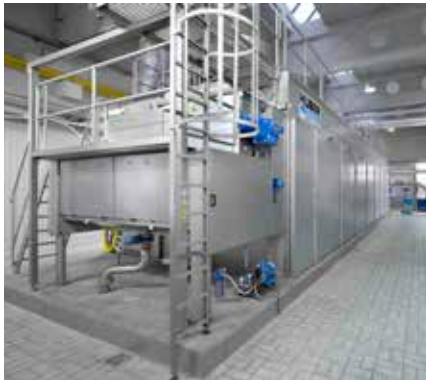
Sécheur à bande BT HUBER pour boues d'épuration. Séchage jusqu'à > 90% DR.
