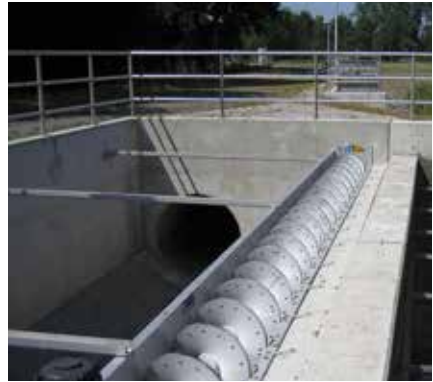
Tamis HUBER ROTAMAT® RoK1 installé sur le côté sec du déversoir.
