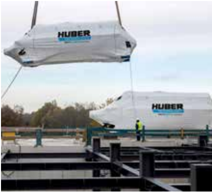
Un sécheur à disques HUBER RotaDry® pendant l'installation sur site.
