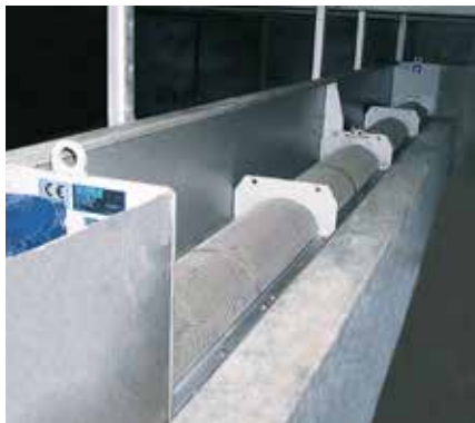
Dégrilleur HUBER ROTAMAT® RoK2 installé sur le côté sale du déversoir.
