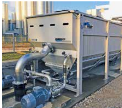
Installation de flottation HDF S pour les charges solides élevées.
