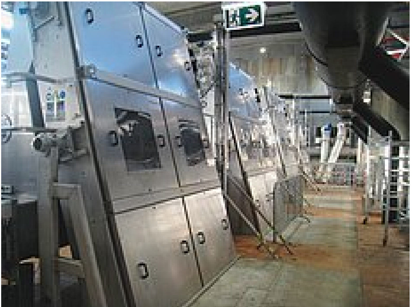
Mécanique HUBER ultra-moderne dans la plus grande station d'épuration de Haute-Autriche Linz-Asten
