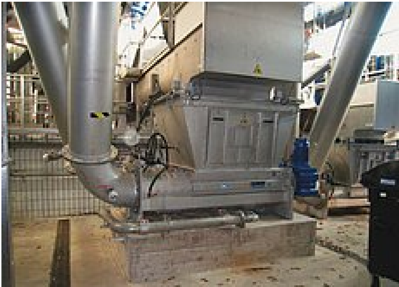
Laveur HUBER WAP 2x8 avec un débit de 16 m 3 /h
