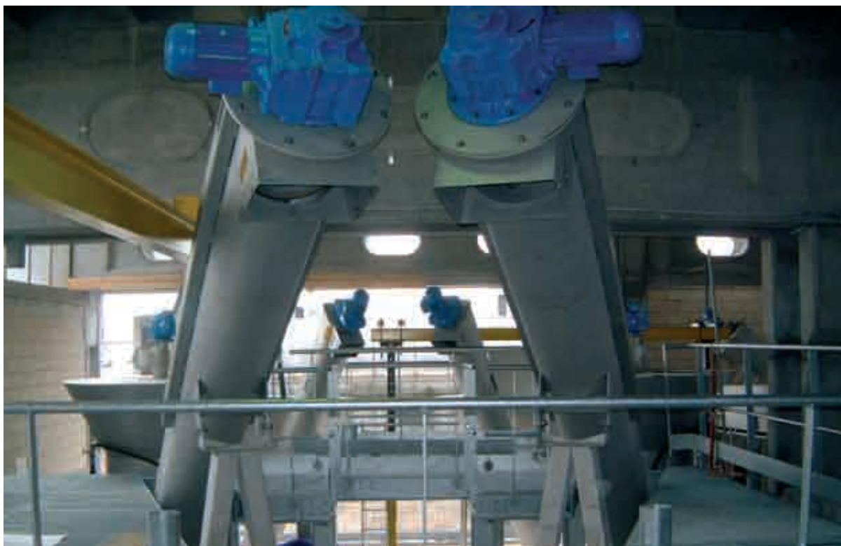
Unité de lavage des sables de Valenton (Paris) : 2 unités COANDA taille 3 et 3 unités COANDA taille 2 S3 (12 tonnes de sable lavé par heure)
