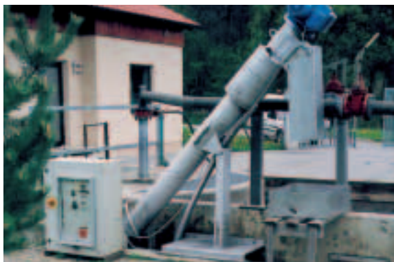
Tamis Ro 9 installé à 48°
