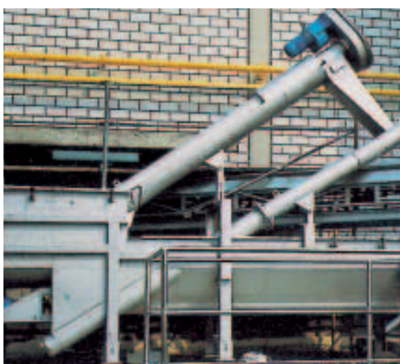
Unité ROTAMAT® Ro 9 couplée à un dessableur longitudinal pour un prétraitement complet
